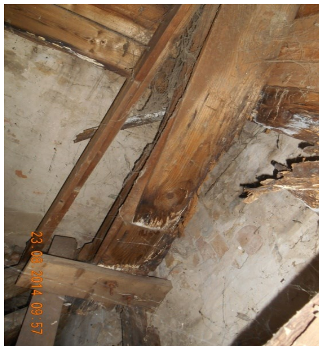
Slika 10. Oštećenja u zoni oslanjanja zakrivljenih nosača.
