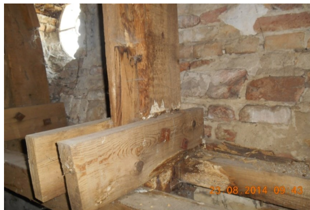
Slika 9. Oštećenja u zoni oslanjanja zakrivljenih nosača.
