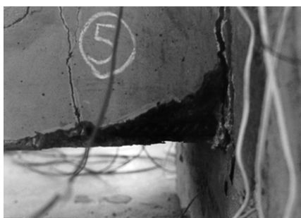
Slika 11 – Model EM-5: Prikaz pukotina u modelu i dela slomljenog zaštitnog sloja
