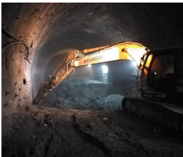
Slika 10 – Iskop podnožnog svoda hidrauličnim bagerom HYUNDAI Robex 220LC 9S, izvor: Avdić, A., 2020
