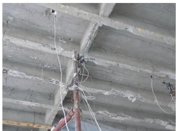
Slika 2 – Karakterističan izgled konstrukcije (rebra i ploča) i karakteristična oštećenja (segregacija betona i ogoljenost armature nosača-rebara zbog oštećenja betona)
