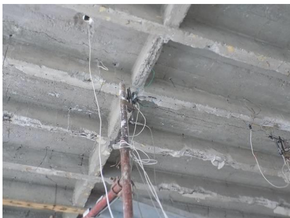
Slika 2 – Karakterističan izgled konstrukcije (rebra i ploča) i karakteristična oštećenja (segregacija betona i ogoljenost armature nosača-rebara zbog oštećenja betona)
