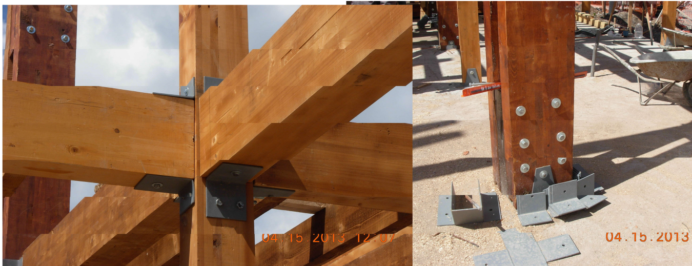
Slike 3 i 4. Detalj veze greda iz četiri različita pravca i unutraš njeg stuba pomoću čelčnih ugaonih veza (levo) i detalj veze unutrašnjeg stuba složenog poprečnog preseka sa temeljnom konstrukcijom (desno).
